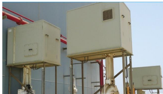
FireShelter на территории резервуарного парка
